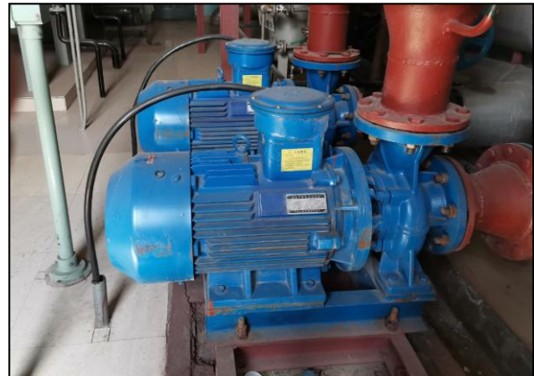
图 2-5 本项目更换 2 台循环泵现状
