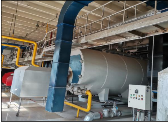
图 2-2 本项目更换 3#热水锅炉现状
