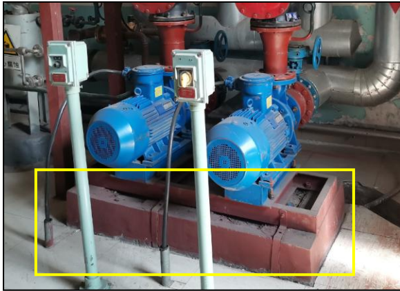
图 3-1 本项目机泵减震基础
