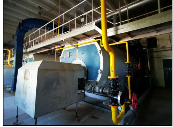
图 2-3 本项目更换 4#热水锅炉现状
